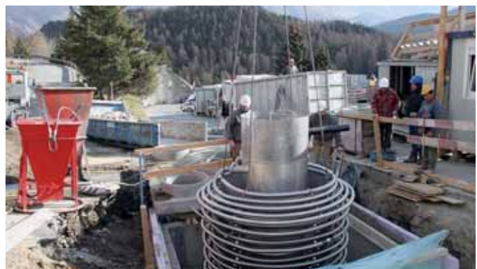
Dieser Abwasserschacht dient als Primärquelle zur Warmwasseraufbereitung.
