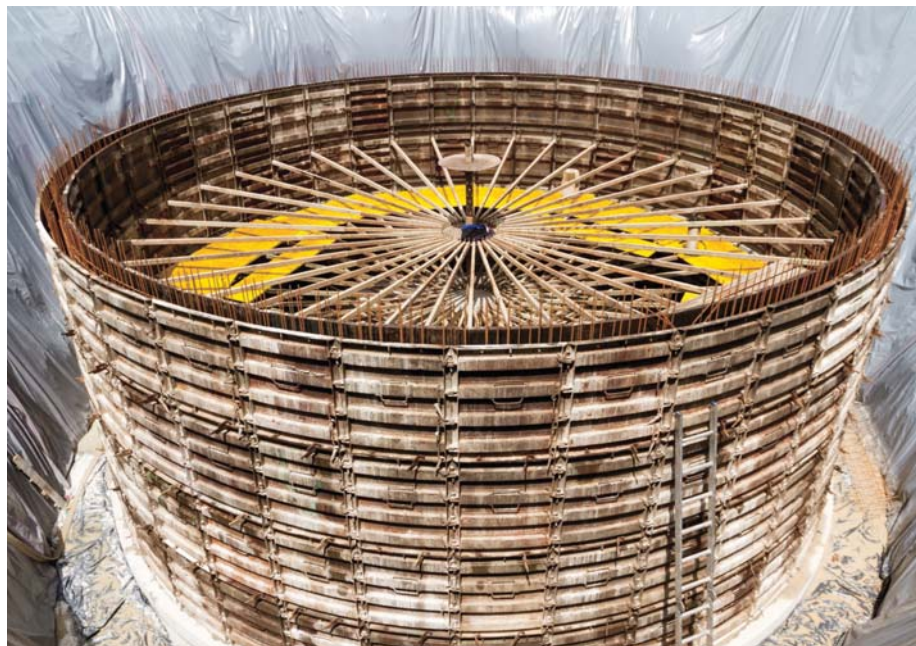
Die Abmessungen des Eisspeichers werden nach der jeweiligen Leistung individuell berechnet.
